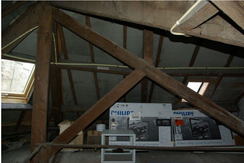
Afbeelding 39 Halfspant ter plaatse boven de ronding van de gevel
