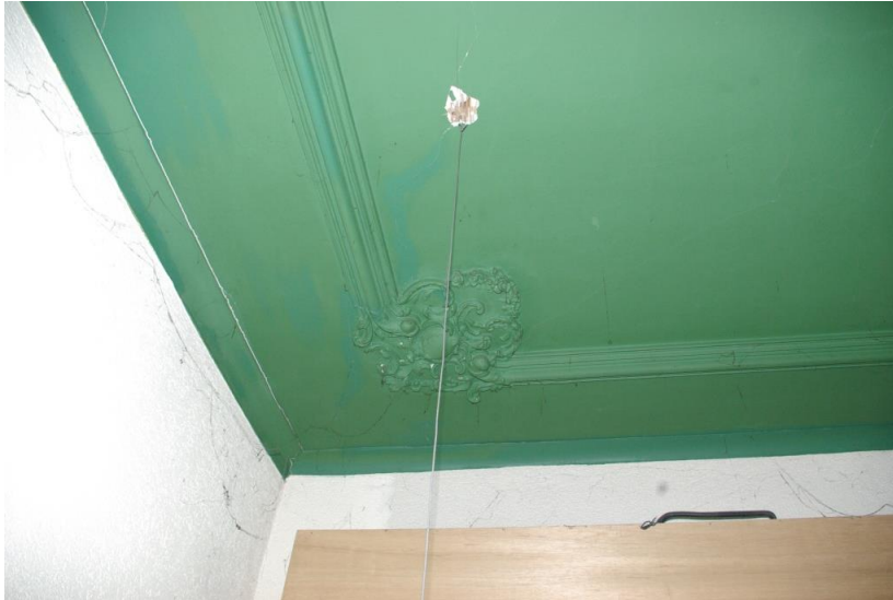
Afbeelding 20. Stuc op riet plafond ruimte 4
