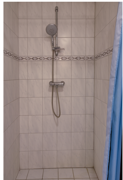
1 x douche per verdieping
